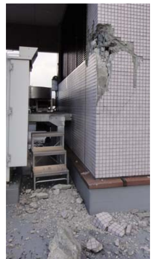
福島県立医大病院屋上機械室
